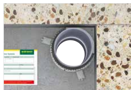
Rury w narożnikach pomieszczeń (Rzopaski). Odległość rury od ściany ≤ 10 mm.
