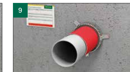
Przejście należy oznaczyć tabliczką BIS Pacifyre® EFC.
